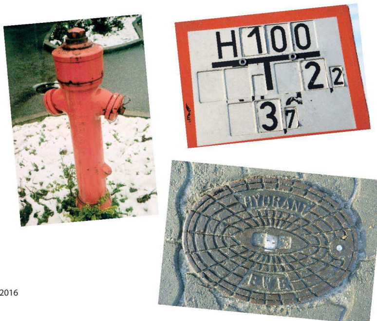
Abb. 3: Über-, Unterflurhydrant und Hinweisschild. H 100 gibt den Durchmesser der Wasserleitung in mm an. 2,2 bedeutet: „Gehe 2,2 m nach rechts.“, 3,7: „Gehe 3,7 m nach hinten“
